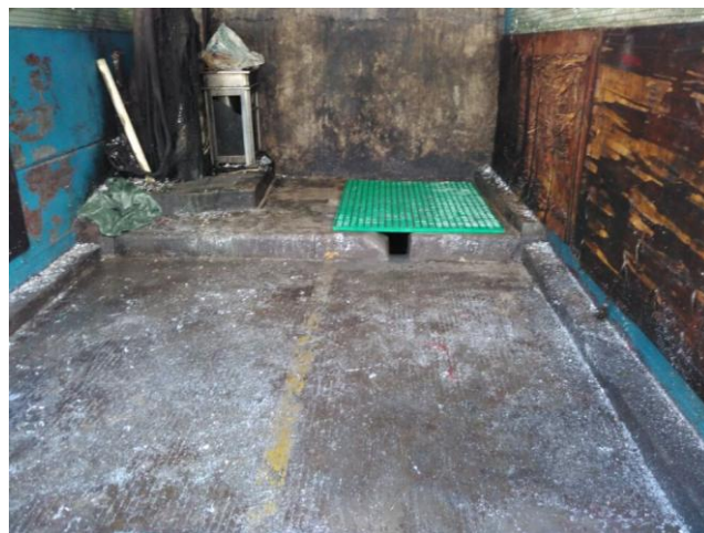
污泥和铝屑的储存场所的防渗措施
